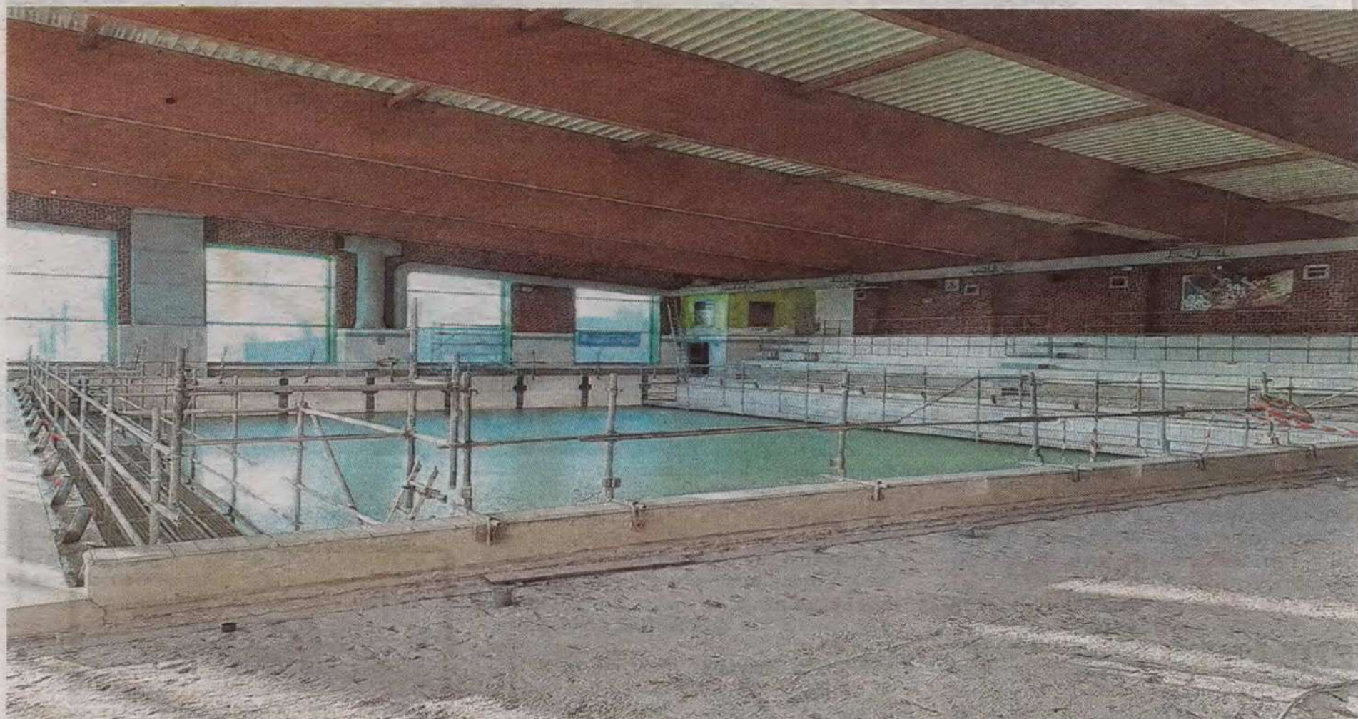
Les travaux sont encore en cours dans le grand bain de la piscine Léo Lagrange.
